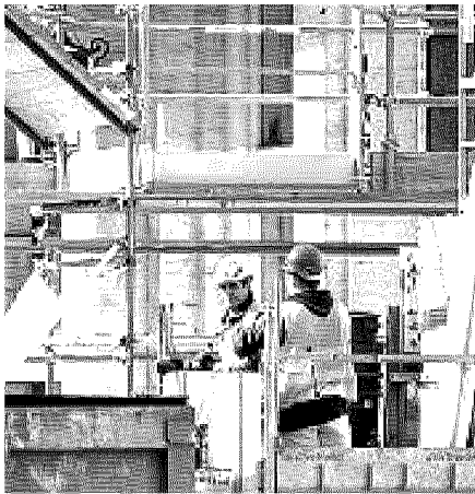
Operai al lavoro in uno dei tanti cantieri che sono aperti in questi mesi nella nostra città (foto LaPresse)
