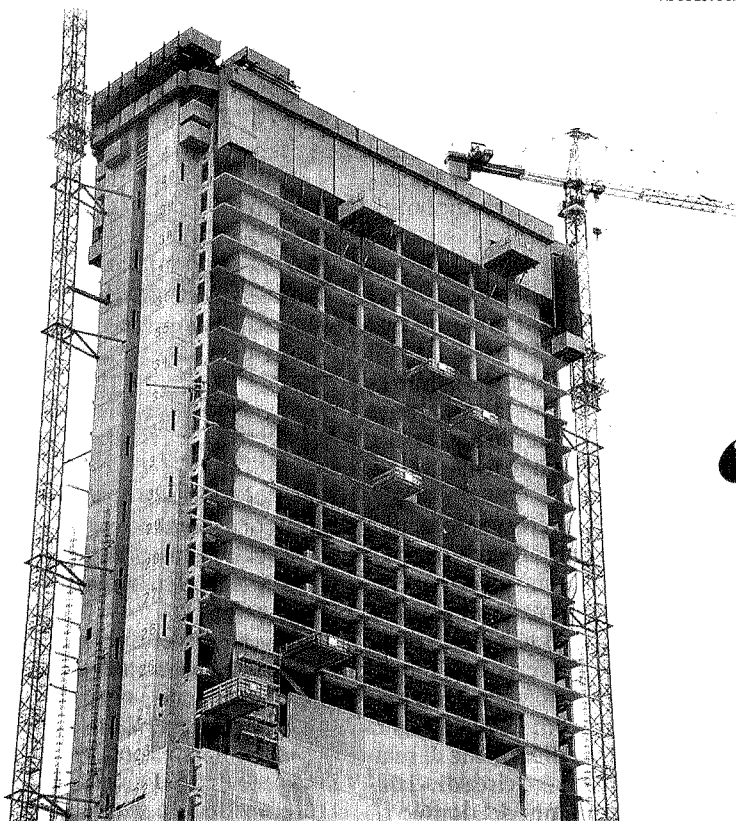
Fase iniziale. La costruzione di torre Isozaki, oggi sede di Allianz, a Citylife, a Milano
