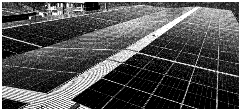
I pannelli installati sul tetto di due capannoni a Leinì (To)
