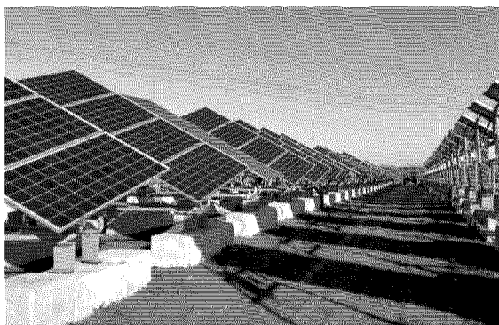
Un parco solare
