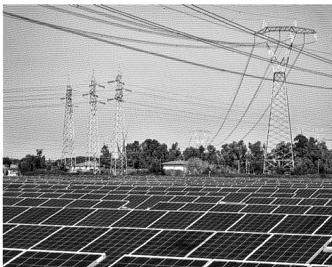
Infrastrutture. Linee elettriche gestite da Terna
