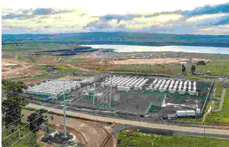
Il caso. Un'infrastruttura di stoccaggio di energia dell'azienda Fluence
